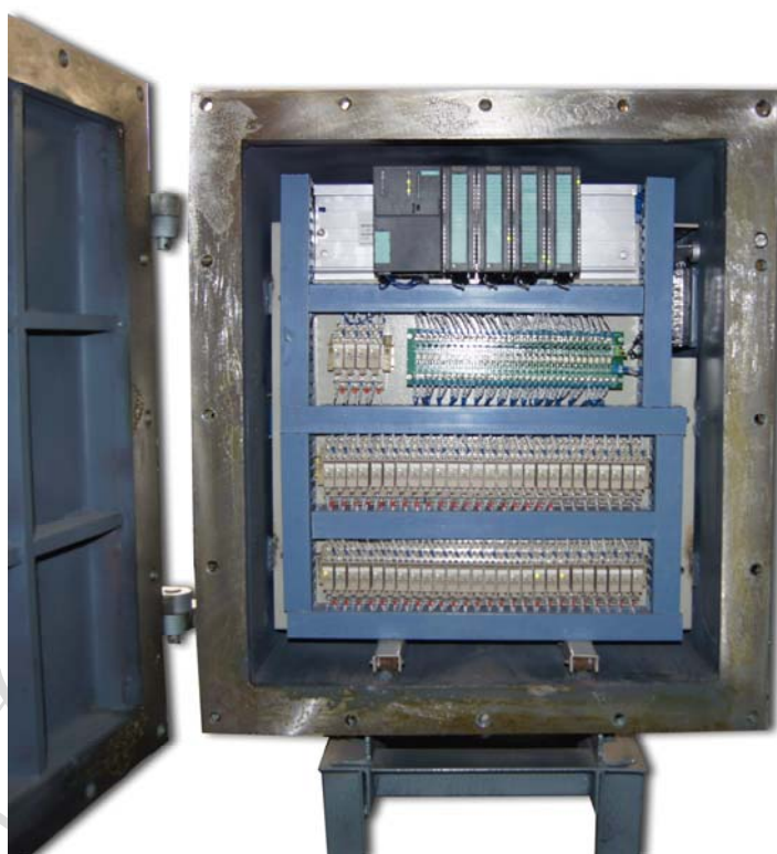
图 5 PLC 控制箱内部结构图
